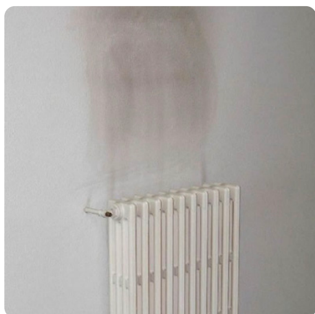
Baffi da termosifone
